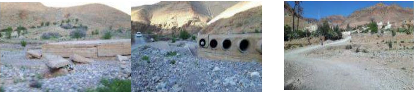
Figure 8 : Ouvrages de franchissements détruits sur la route en direction de Maguenoun.
