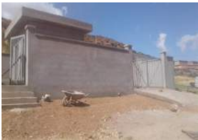
Figure 3 Local de pompage Ait Hssayn
