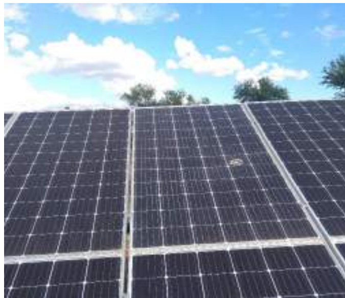
Figure 4 : Panneaux solaires, un des panneau a été endommagé par un jet de pierre
