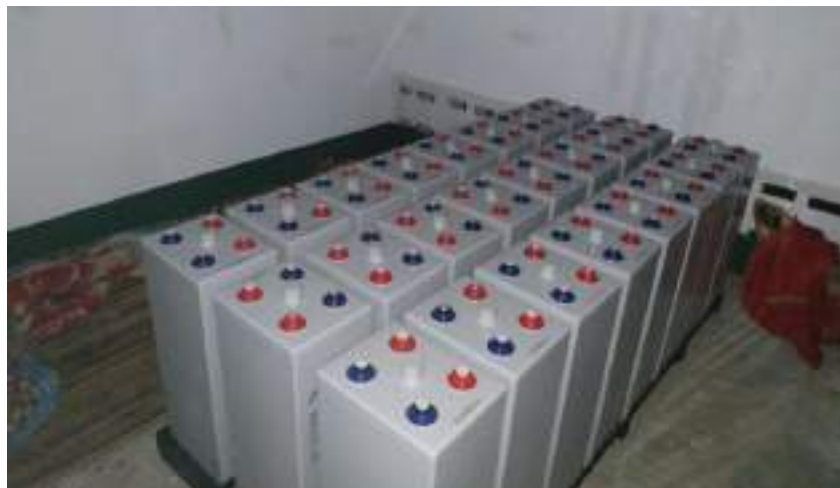
Figure 10 : Batteries installées dans le local technique
