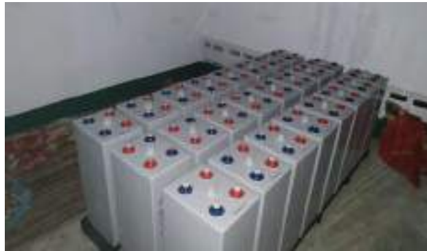
Figure 22 : Batteries installées dans le local technique
