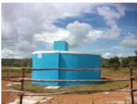
Château d'eau de 50 m 3
