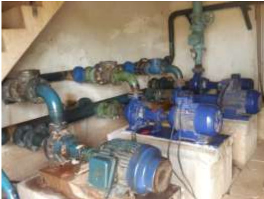
Les pompes de refoulement
