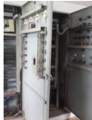
Armoire électrique et de dosage
