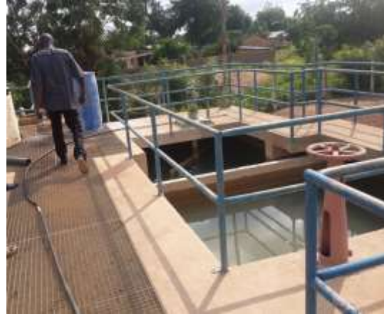
Vue de la chaine de traitement 1
