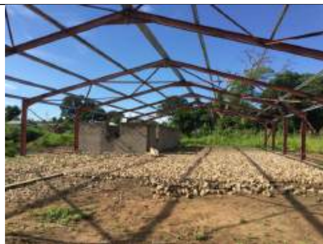
Figure 38 : Construction des locaux techniques sous la charpente. L'espace restant sera laissé à disposition de la commune pour établissement d'un marché et développement des activités génératrices de revenus
