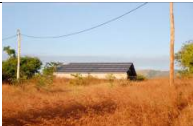
Figure 33 : Centrale photovoltaïque d'Ampasindava
