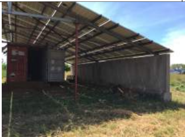
Figure 35 : Conteneur avec les équipements de conversion électriques et de stockage
