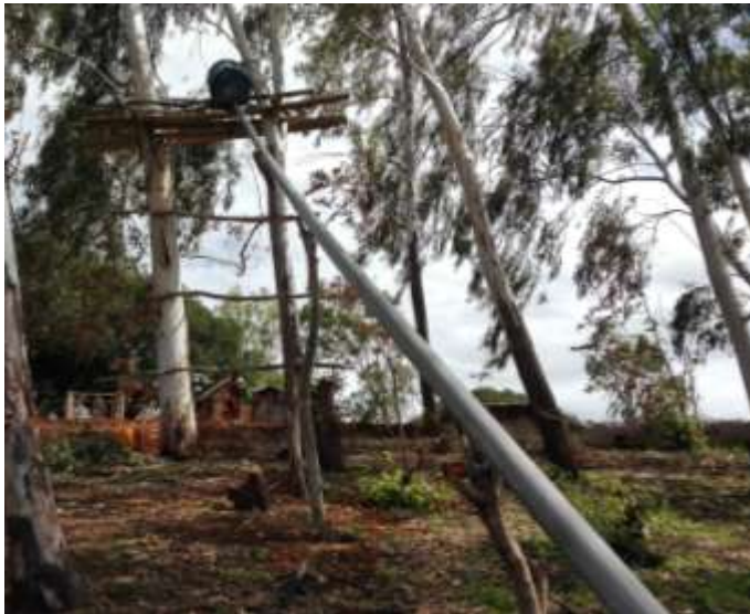
Figure 10 : Tour de traitement. Le réservoir est situé à 8 m de haut. Une vanne de protection en sortie de réservoir permet d'isoler la gaine du réservoir
