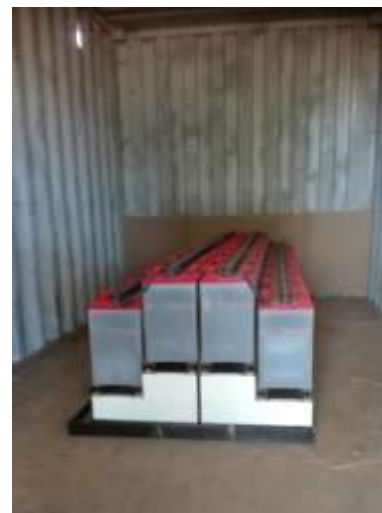
Figure 4 : Parc de batterie
