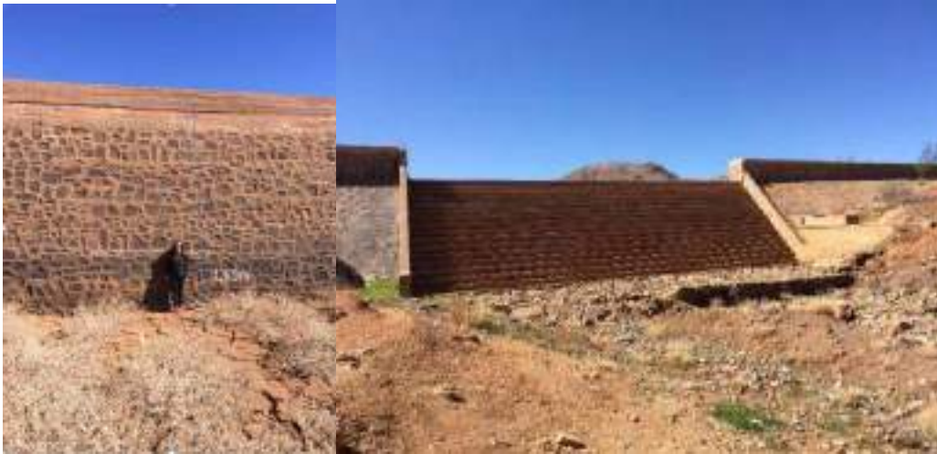
Figure n°6 : Photographies du barrage de Sellaoun en mars 2018 (aval à droite et amont à gauche), constat de la sédimentation
