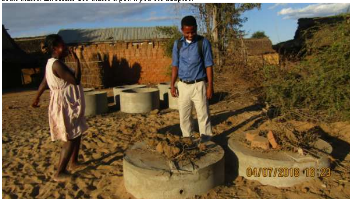
Figure 16 – Latrine en cours de réalisation à Ambahikily. A gauche la bénéficiaire, à droite Gildas, consultant assainissement.
