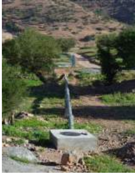
Photo 5 : Conduite à laquelle il manque des vices de fixation
