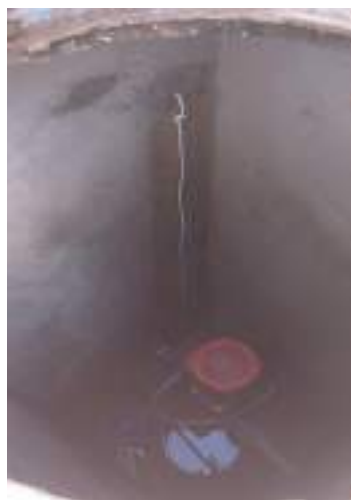
Photo 12 : Local de la pompe avec intrusion d'eau (défaut de conception)
