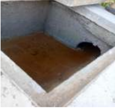
Photo 1 : Regard avec des effluents stagnants.
