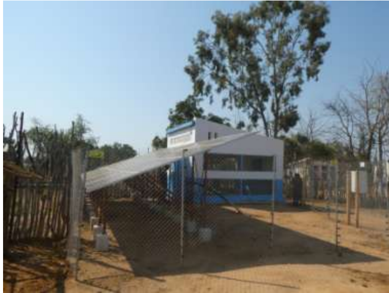
Figure 15 : Installation solaire à Ankililoaka
