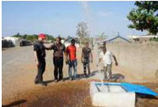
Figure 5 : Purge du réseau lors de la réception provisoire des installations d'AEP d'Ambahikily
