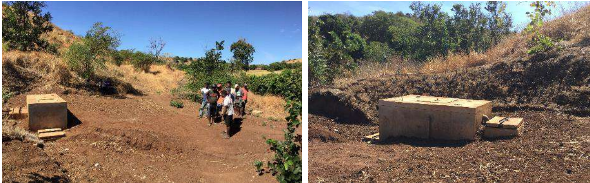
Figure 10 : Bassin de mise en charge
