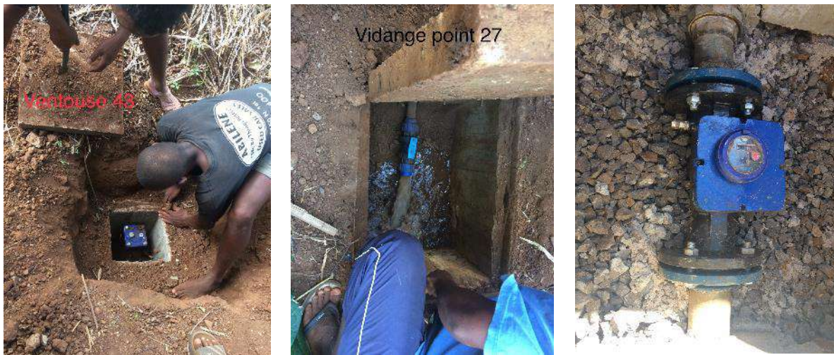
Figure 17 : ventouse purgeur, vidange et compteur
