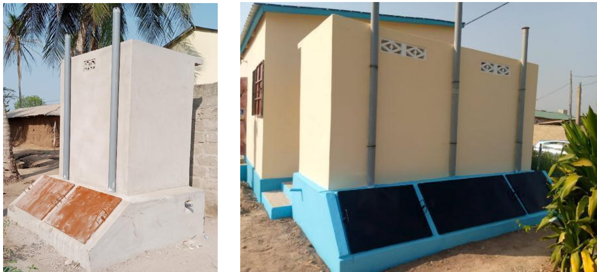
Figure 22. Exemple d'une latrine ECOSAN en cours de construction (gauche) et réceptionnée (droite) à Sikakondji.
