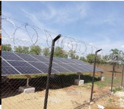
Figure V-2 : Clôture des panneaux solaires
