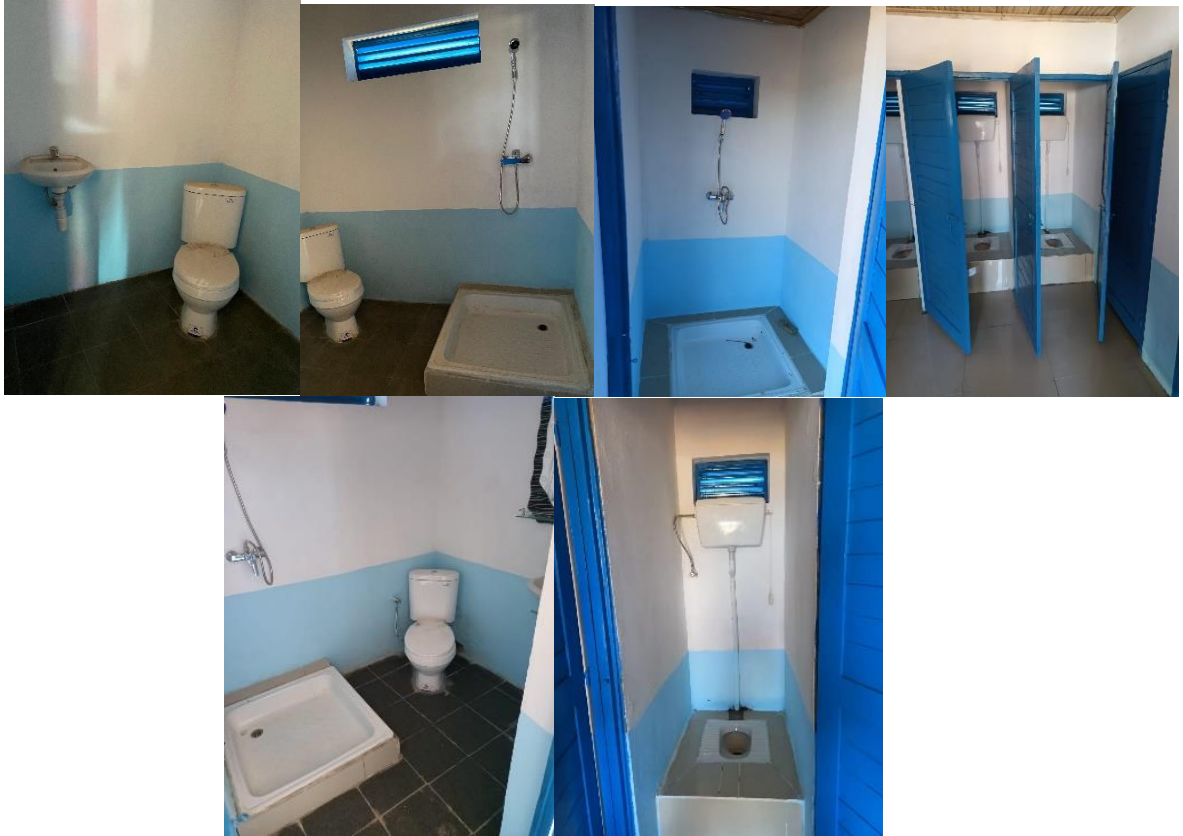
Figure VIII-4 : équipement sanitaire du bloc sanitaire d'Andranohinaly
