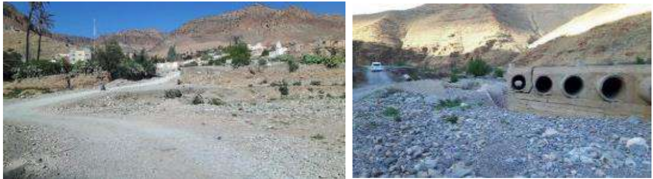
Figure 17 : Photographies de l'ouvrage de franchissement détruit
