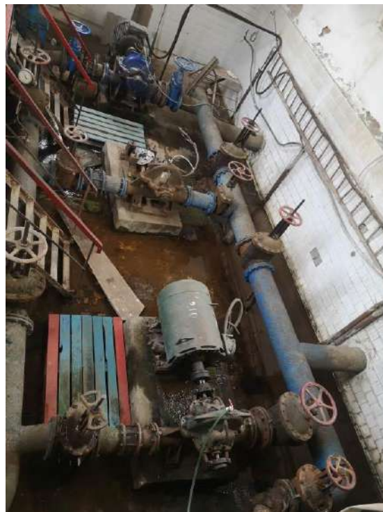
Figure 5: Intérieur du bâtiment de la station de reprise du site C
