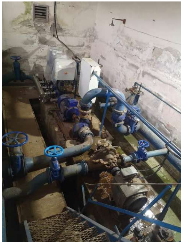
Figure 3: Station de pompage de reprise existante sur site B
