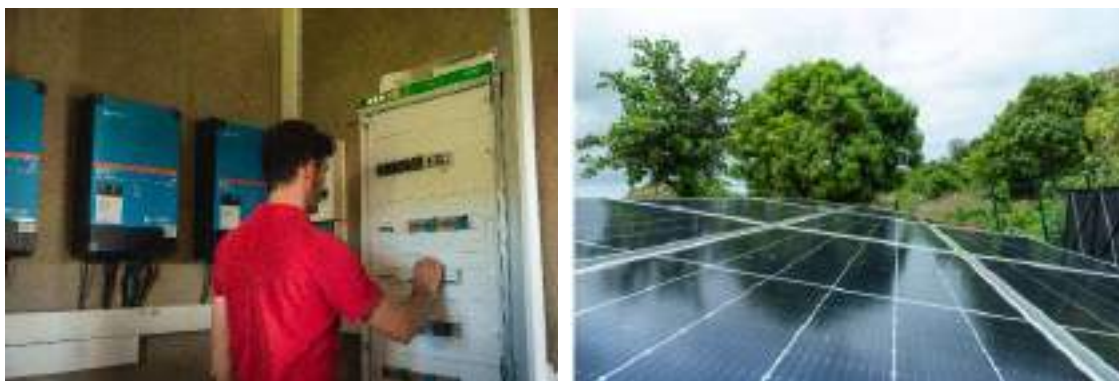
Figure 14 : Photos du local technique et des panneaux solaires
