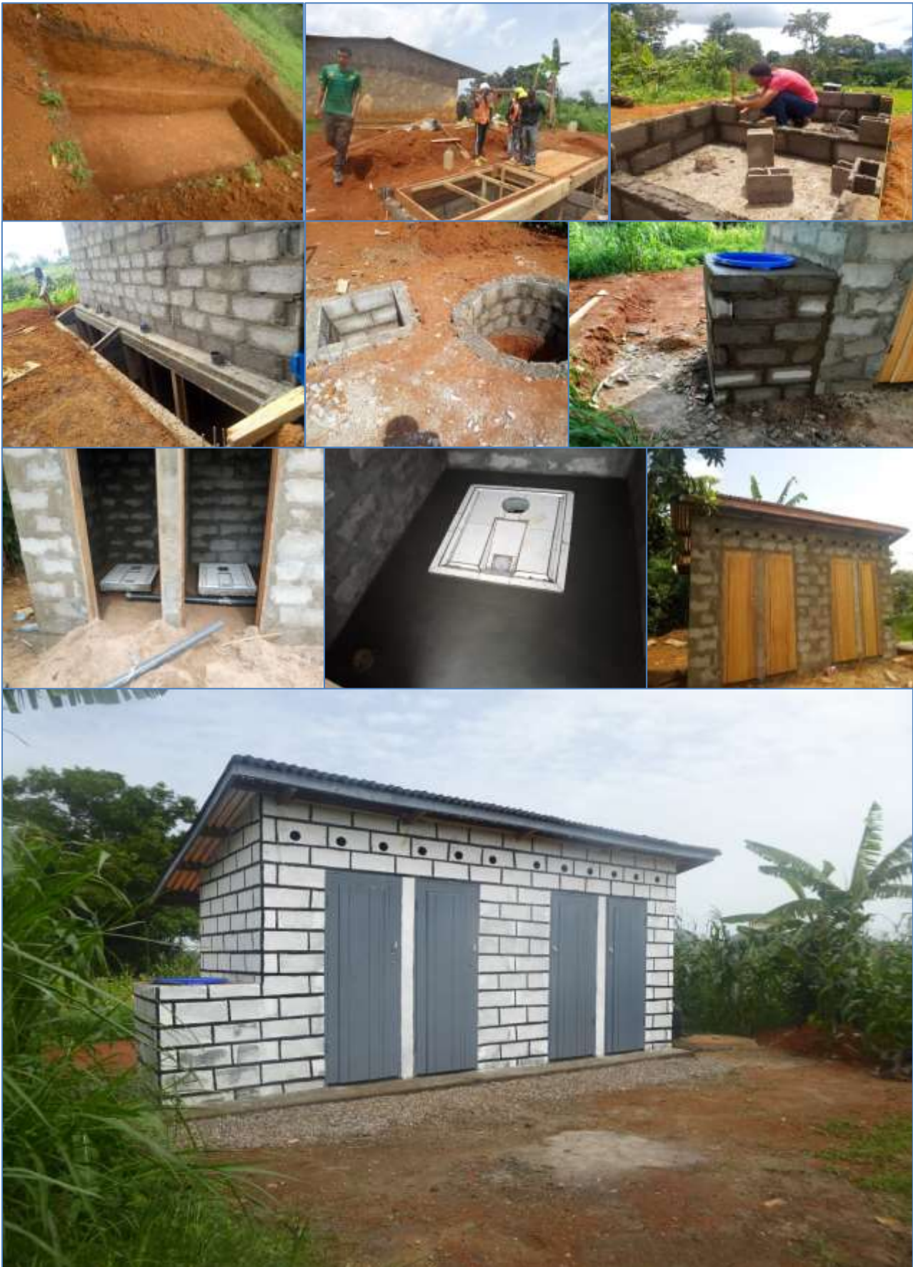
Clichés des différentes étapes de construction à titre pilote du bloc de quatre latrines écologiques à l'école publique de BINGUELA. Travaux supervisés par le stagiaire d'Experts-Solidaires affecté au Cameroun
