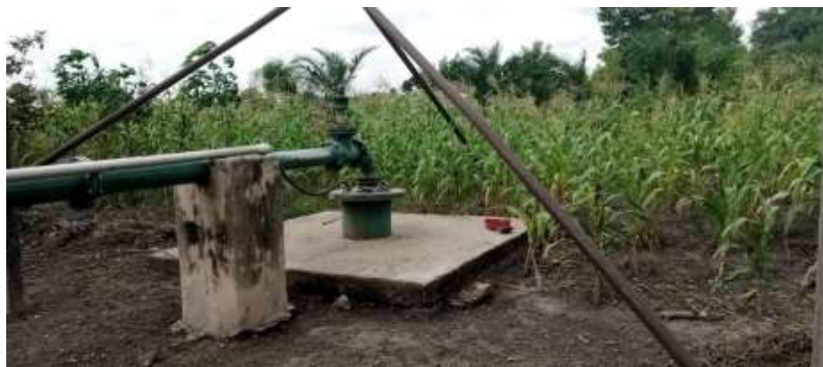
Figure 15. La tête de forage de F1 est située à proximité directe de cultures de maïs où sont potentiellement épanchés des engrais et pesticides chimiques (01/07/2023)
