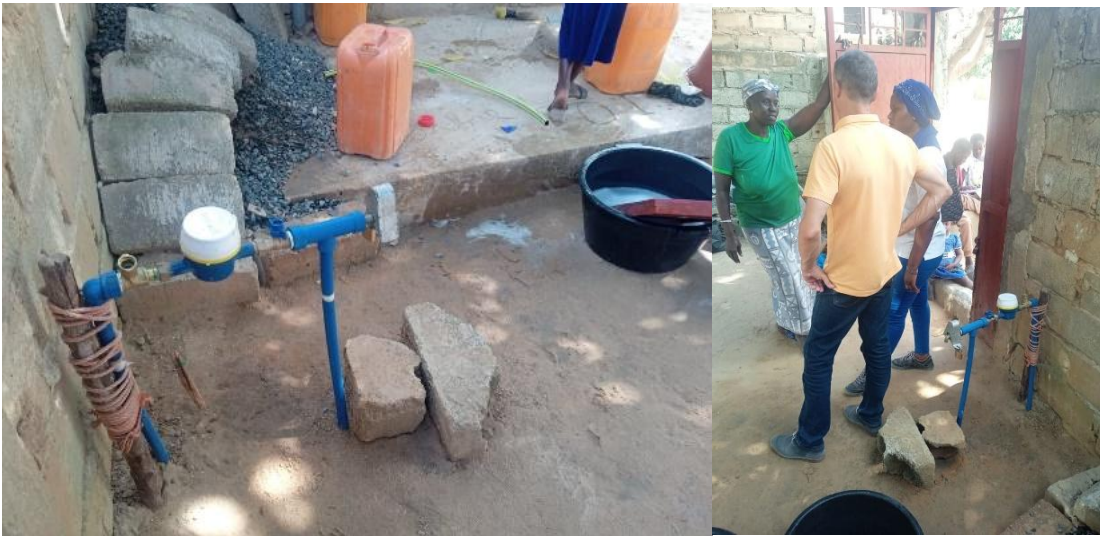
Figure 11 : Branchement particulier dans une habitation
