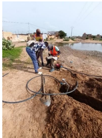
Branchement particulier dans une habitation après pose du réseau d'extension par le projet
