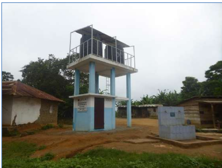
Mini-adduction photovoltaïque construite dans le village NKOL en 2021 sous financement BIP-MINEE © AUNTD 2022
