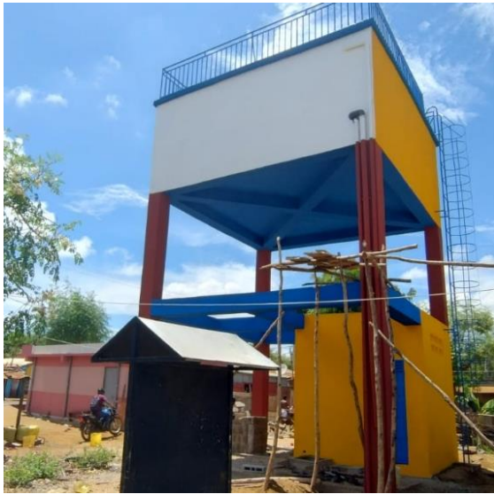
Figure 5 : Site de SCAMA Nord (réservoir et kiosque de distribution) - Mars 2026
