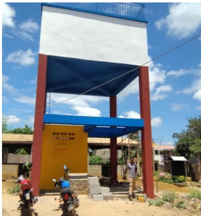
Réservoir de SCAMA Nord – Antsiranana - Mars 2026
