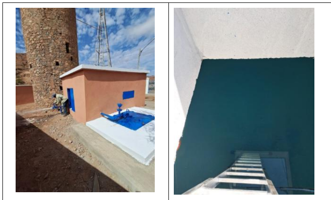
Figure 34 Essai de mise en service
