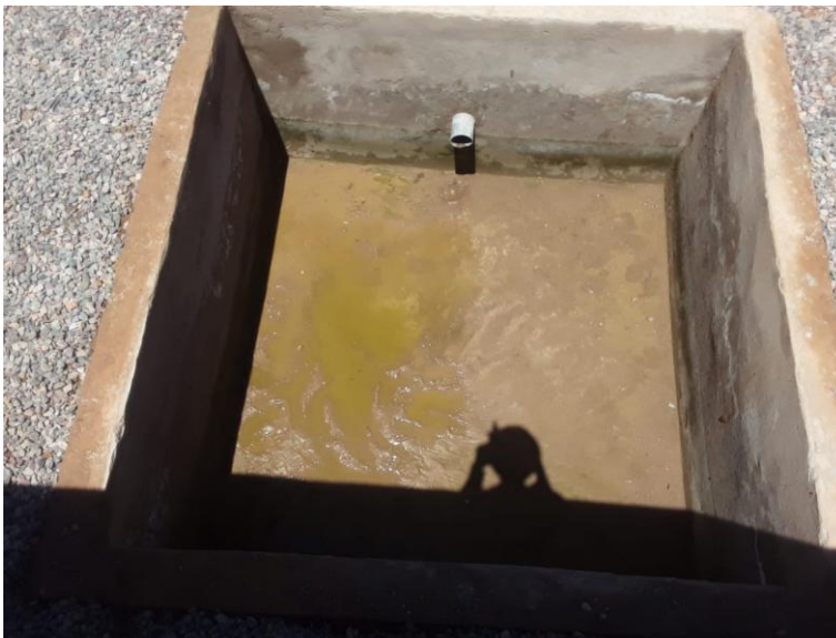
Figure 17 : Regard de récupération des eaux usées épurées
